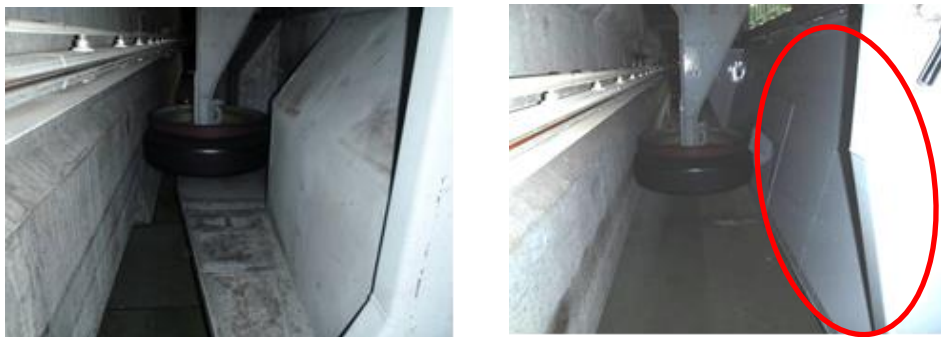
車両スカートの改良（右：改良後）
