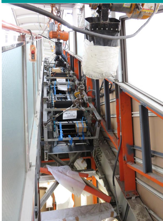
エスカレーター更新（万願寺駅連絡通路）
