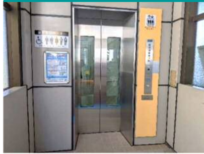
改札階のエレベーター
