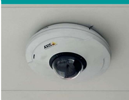
駅構内の防犯カメラ
