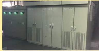
非常用蓄電池
